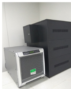
不间断电源 UPS
